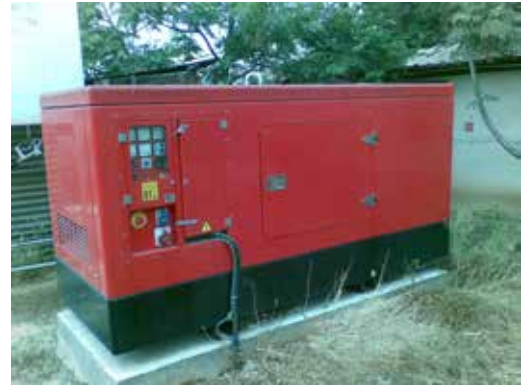
Mantenha os geradores em bom estado
