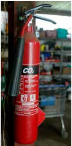
Os extintores devem ser facilmente acessíveis
